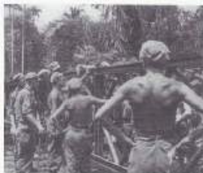
Personeel van de 11e Veldcompagnie Genietroepen slaat een dalybrug in de omgeving van Bultenzorg.
