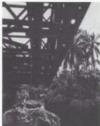
Een brug gelegd op deels vernielde pijlers
